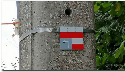
Abbildung 2.16: Umreifung an einem Mast
